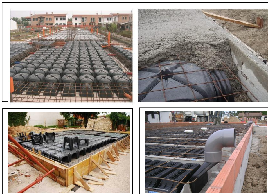
Fig.20 - Cupolete din material plastic, modulare, utilizate pentru realizarea “subsolului” necesar ventilării, în vederea eliminării radonului [20, 21]
