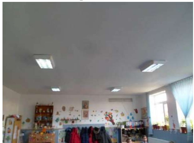
Sistemul de iluminat
