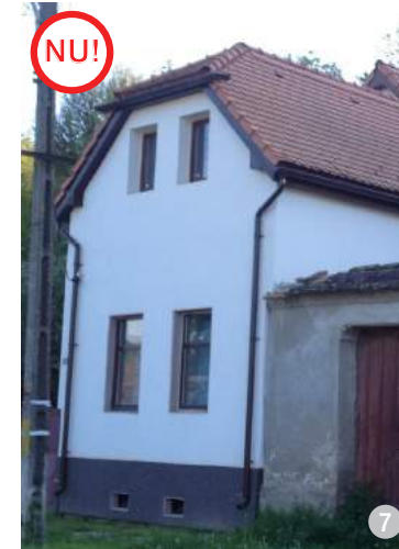
AȘA NU: Modificarea gurilor de aerisire nu este permisă în vederea amplasării unor ferestre. Aceasta aduce grave modificări aspectului general al fațadei. (Richiș, jud. Sibiu)
