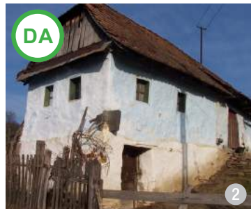
Casă românească cu pereți de lemn așezați pe un demisol construit din piatră. (Săsăuș, jud. Sibiu)
