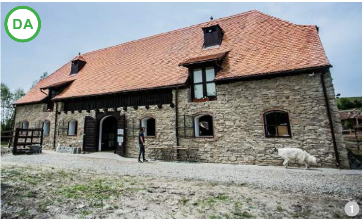
DA AȘA DA: Zid mixt din piatră de gresie, cărămidă și elemente din beton, care combină tehnica tradițională cu cea contemporană, pentru a corespunde cerințelor de stabilitate etc. – proiect realizat cu finanțare europeană. (Apoș, jud. Sibiu)
