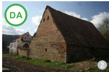
Înălțimea pereților este egală cu jumătate din înălțimea acoperișului (Daia, jud. Mureș)
