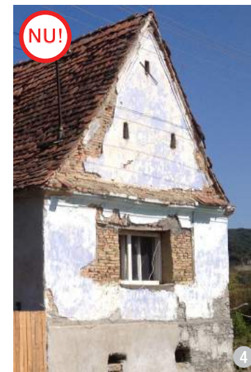
ASA NU: Caz frecvent de modificare inadecvată a golurilor ferestrelor de la fațadă: prin amenajarea unui gol în axul frontonului, se slăbește stabilitatea acestuia, riscând să apară fisuri. (Daia, jud. Mureș)
