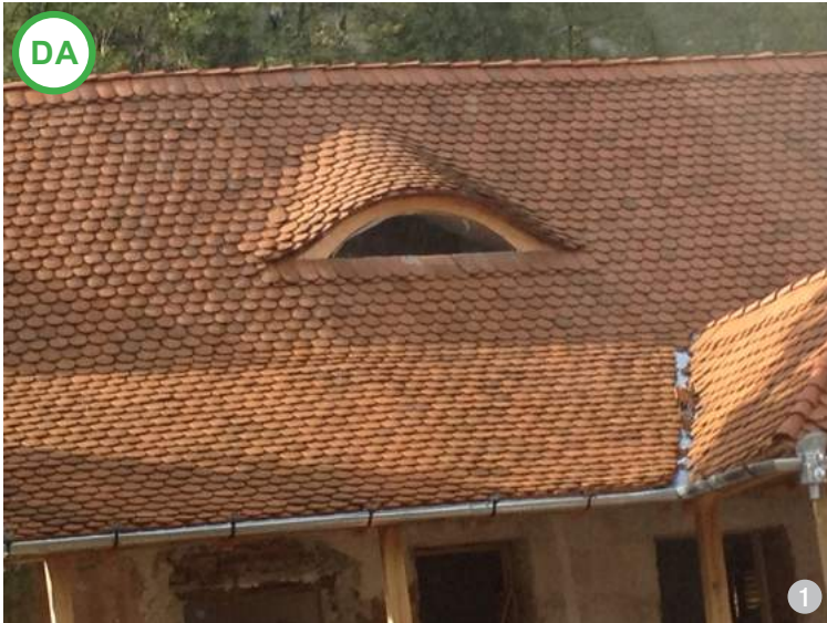
AȘA DA: Lucarnele de tip „ochi de pisică” sunt cele mai folosite pentru a ilumina un pod mansardat. Acestea modifică nesubstanțial volumul acoperișului. (Richiș, jud. Sibiu)
