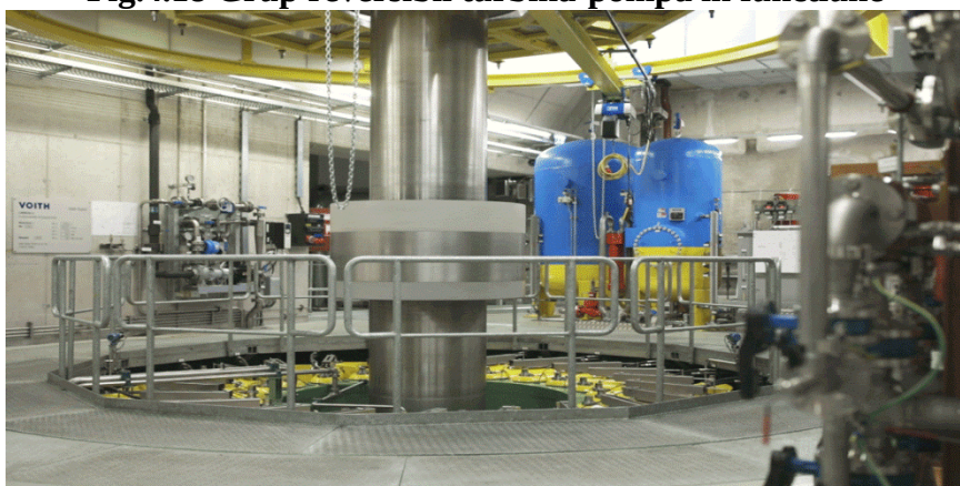
Fig.4.18 Grup reversibil turbina-pompa în funcțiune
