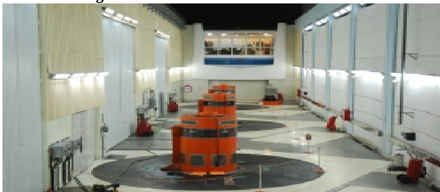
Fig.4.6. Sala mașinilor Centrala Mariselu
